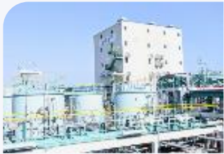
実証プラント
